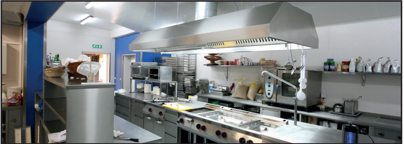
Installationen im Küchenbereich
